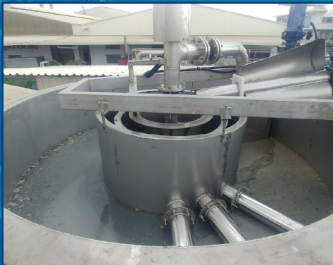
Bể tuyển nổi
